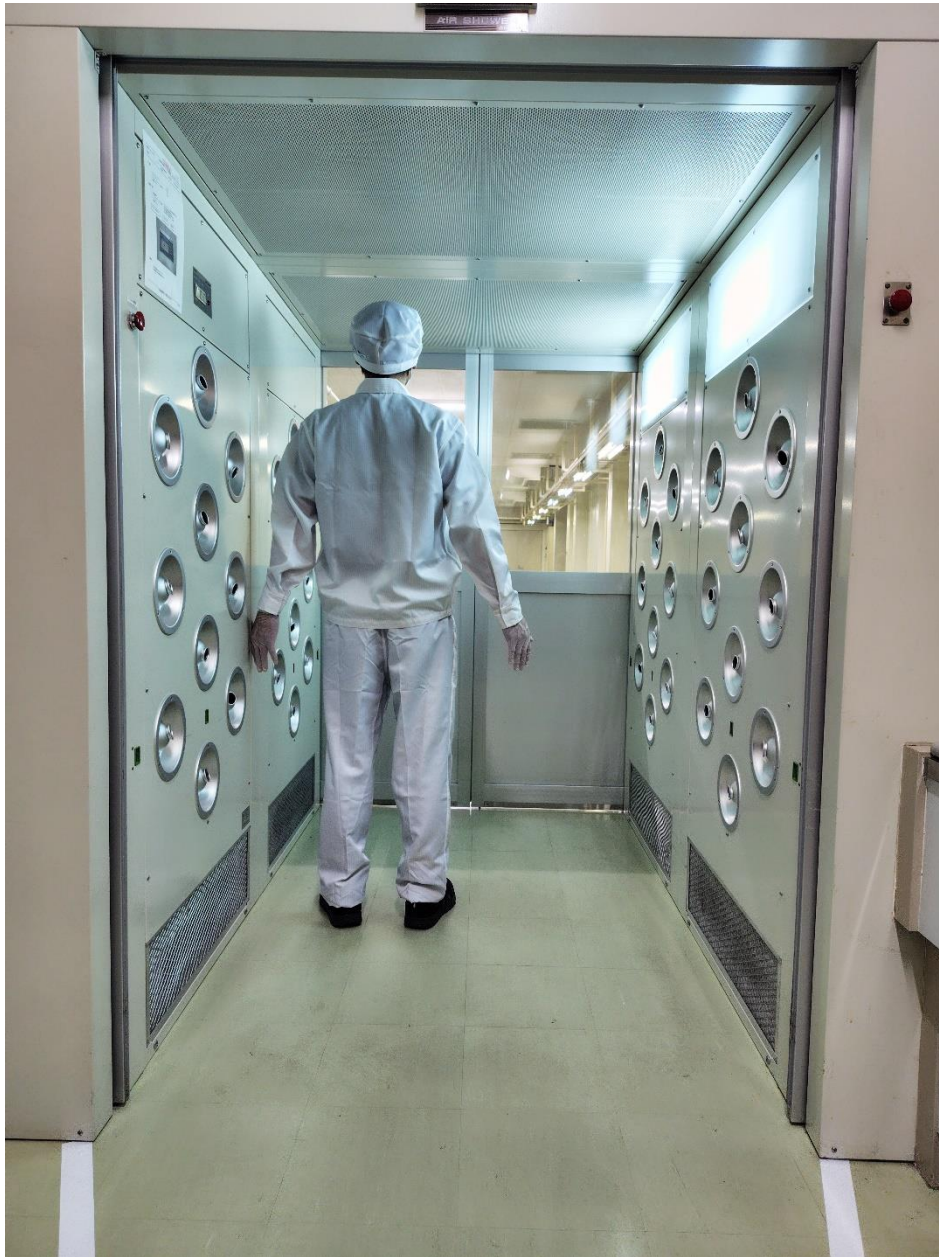
画像キャプション: 日電精密工業 神戸工場のクリーンルーム施設
